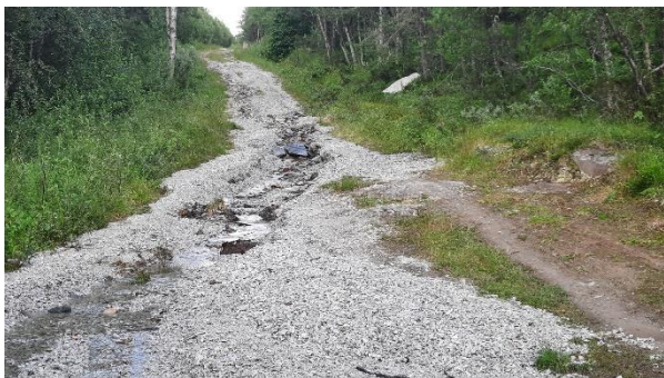
Fjellvegen, skader etter "Hans" i august 2023. Klima-endringene gir økende tilfeller av styrtregn med flom- og rassituasjoner.
