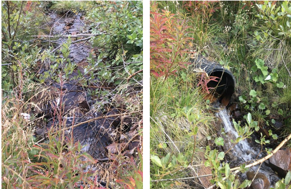
Bilde av mindre bekk som føres i kulvert under veien Utsikten
