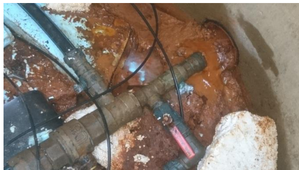
Vannlekkasje i kum (rustvann og jord).
