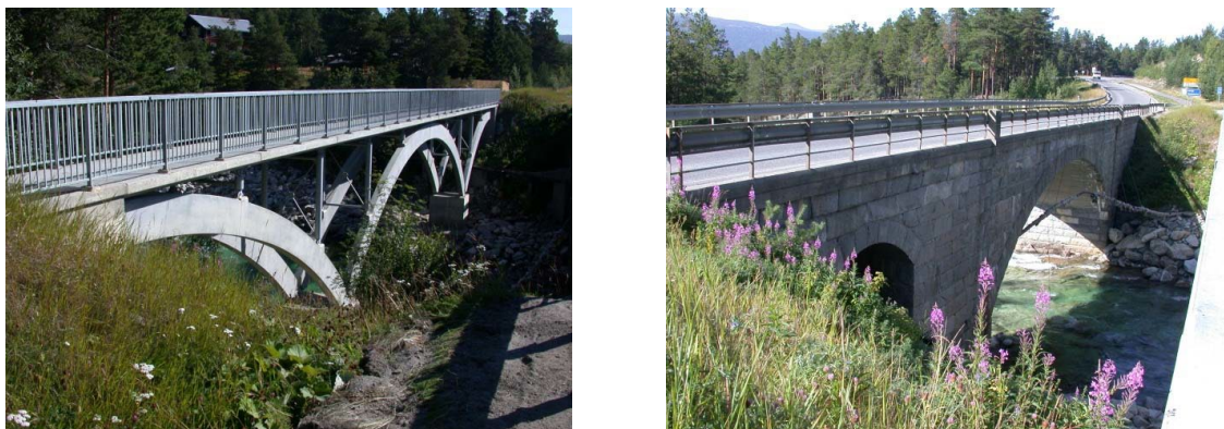
Figur 7 Dagens gangbru til venstre, som blir revet. Dagens kjørebru til høyre er fra 1942.
