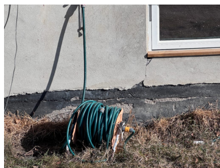
Løs murpuss og oppsprukket "Gudrong" på utsiden
